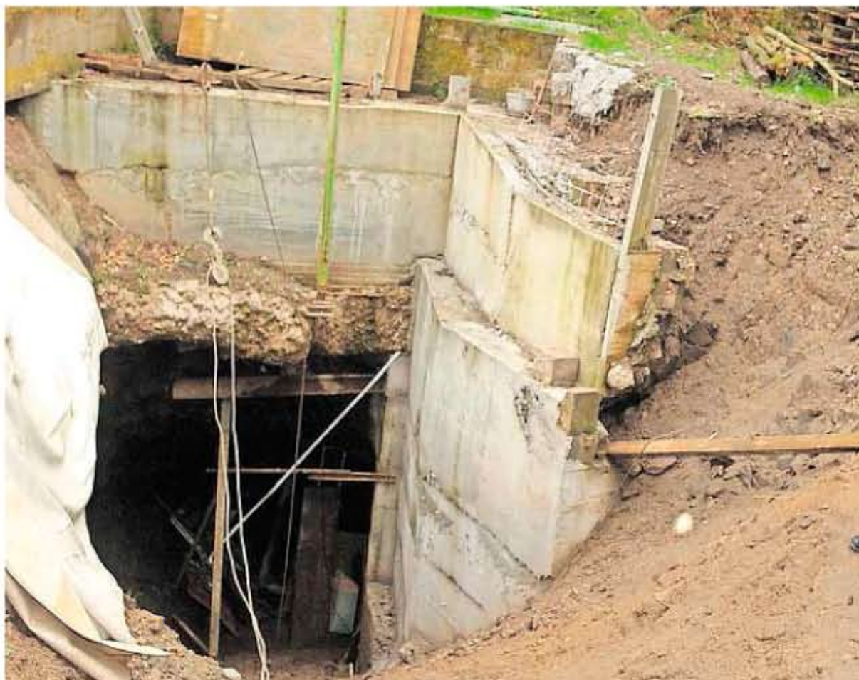
Um einen besucherfreundlichen Eingang zu schaffen, wurde im Jahr 2005 der alte Marienschacht II umgebaut. Noch heute geht es von dort aus auf Bergwerkstour. Archivfotos: Schimmack (1)/ frankphoto.de (2)
